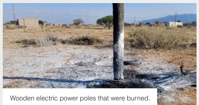
Middelpunt Sub Station
